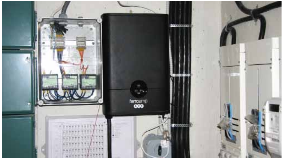
Svenska Ferrosmps batterisystem för energilagring och energistyrning.
